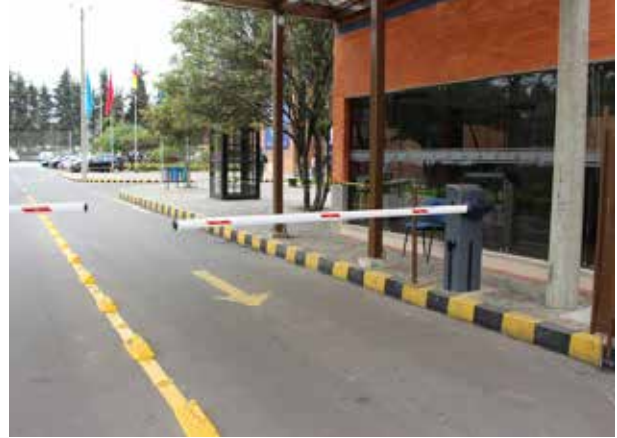
Ingreso a la Sede Principal de Caja Honor a través de lectores de tarjeta.
